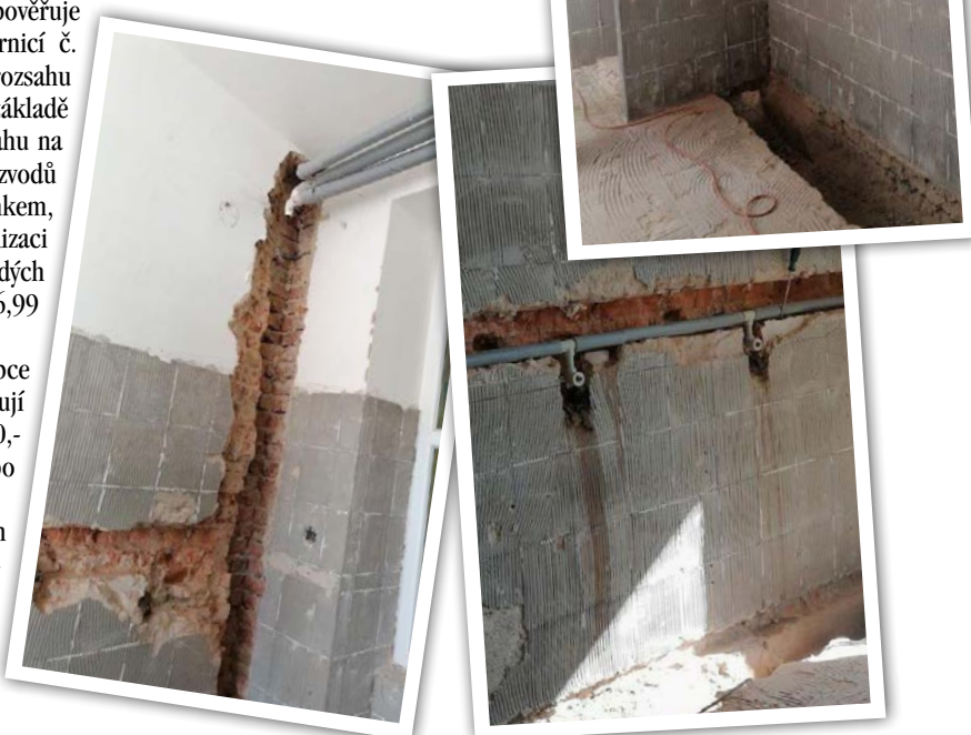
Foto z počínající Oprava kanalizace a výměna silnoproudých rozvodů v MŠ Mokrá-Horákov
